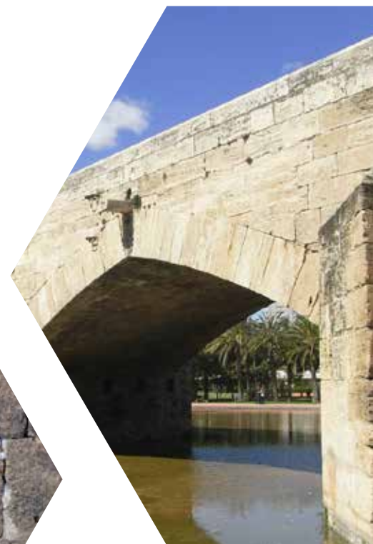
Marques de picapedrer. Pont del Mar de València, segle XVI Marcas de cantero. Puente del Mar de Valencia, siglo XVI
