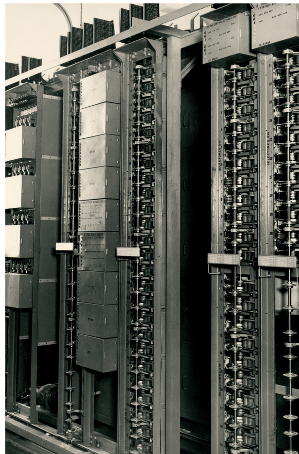
| 13 | Anónimo. Central con sistema de conmutación automática Rotary, Alicante. Anònim. Central amb sistema de commutació automàtica Rotary, Alacant.
