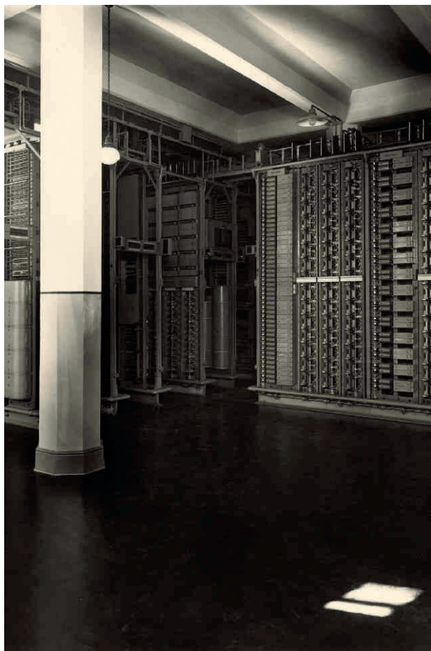
| 12 | Vidal, 1928. Vista general del equipo automático de la Central de Valencia. Vidal, 1928. Vista general de l'equip automàtic de la Central de València.
