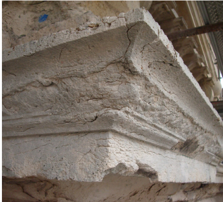
Desconchados (PF7) Spalling (PF7)
