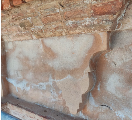
Eflorescencia (RE1) Efflorescence (RE1)
