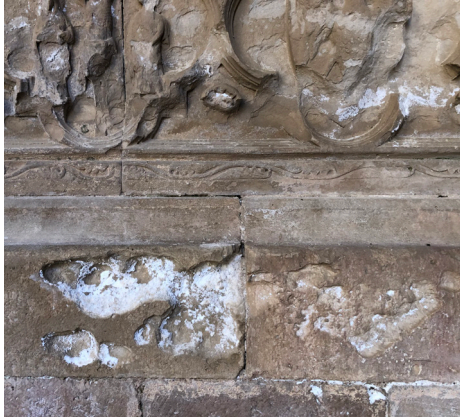
Eflorescencia (PE1) Efflorescence (PE1)
