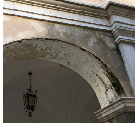
Manchas de carbonatación (RE2) Carbonation stains (RE2)
