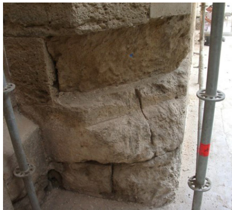
Disgregación (PF10) Disgregation (PF10)
